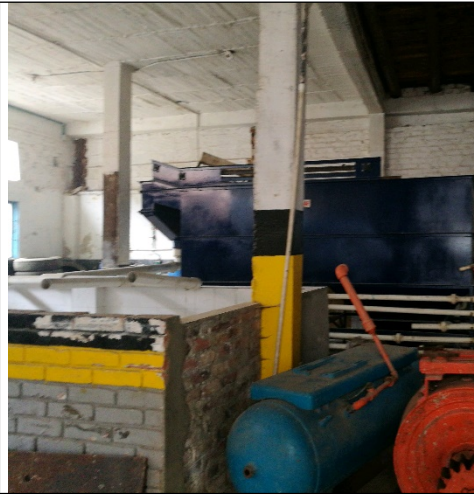
Foto No. 5 Sistema de tratamiento de ARnD.
